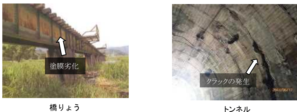
図4: 老朽化が進んでいる施設の例
