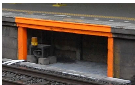
ホーム下の待避スペース
