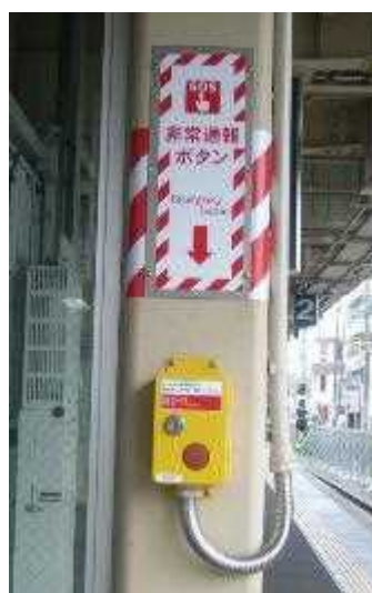
非常停止押しボタン
