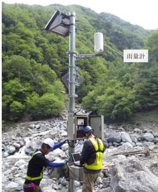
常時監視カメラ、雨量計の設置
