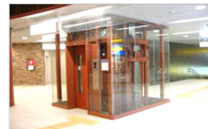
エレベーター
