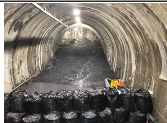
トンネル坑内土砂流入状況
