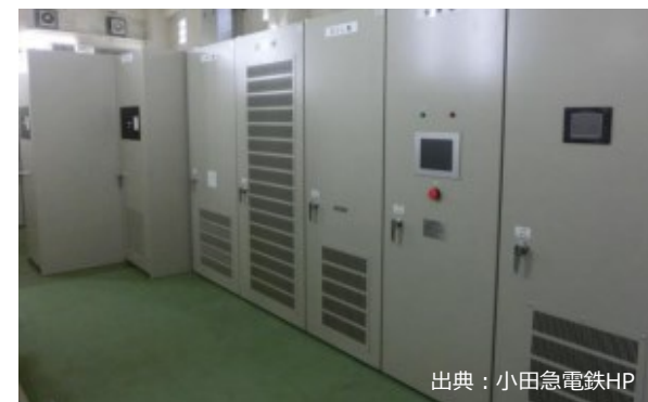
【回生電力貯蔵装置の設置例】
