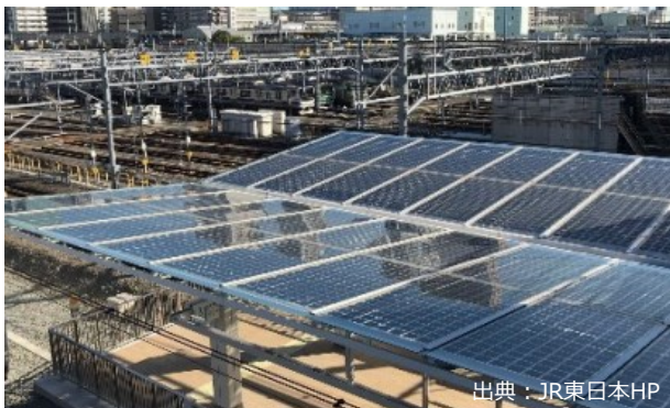
【太陽光パネルの設置例（ホーム屋根部）】
