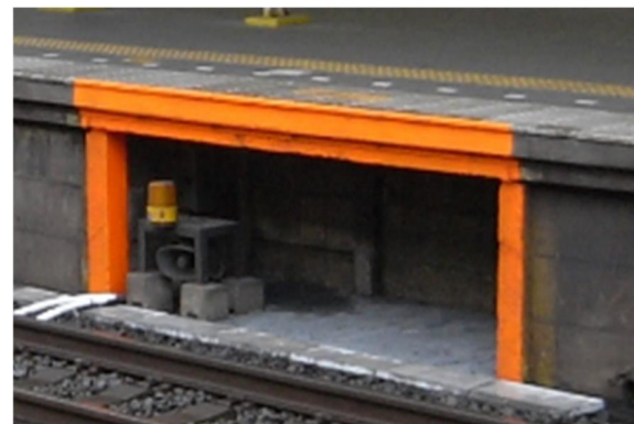
ホーム下の待避スペース
