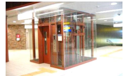
エレベーター
