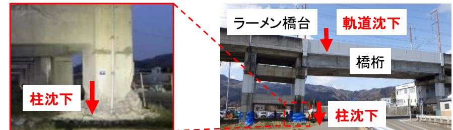
令和4年3月の地震による被害
