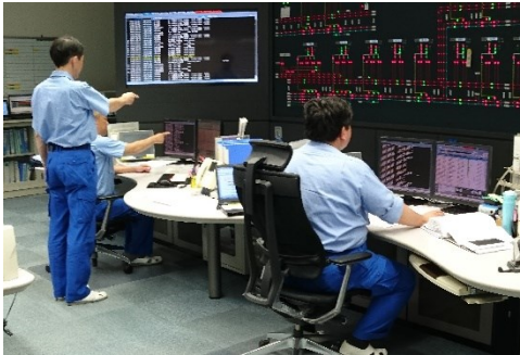
電力管理システム
