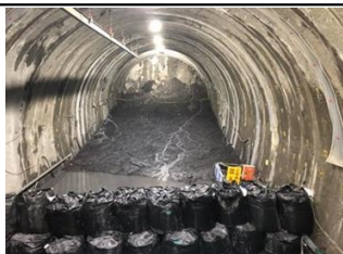
トンネル坑内土砂流入状況
