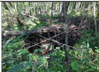
地表面陥没状況
