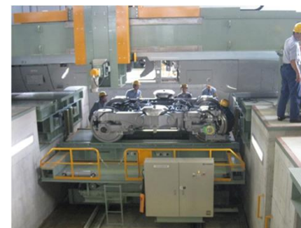
②台車抜取装置
