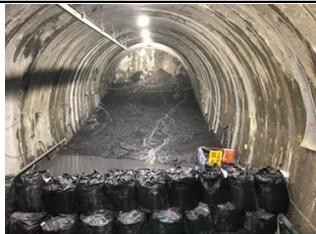
トンネル坑内土砂流入状況
