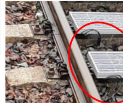
分離型のパネルの配線
