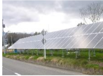
柵塀の設置されない設備
