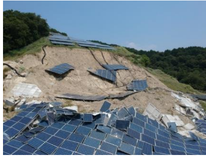
土砂崩れで生じた崩落
