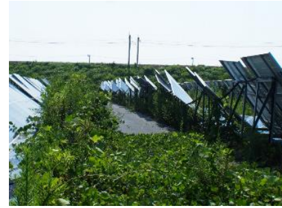
不十分な管理で放置されたパネル
