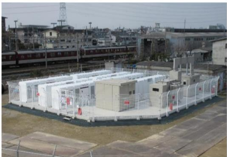
大容量蓄電池システム
