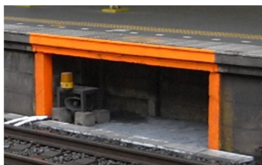
ホーム下の待避スペース
