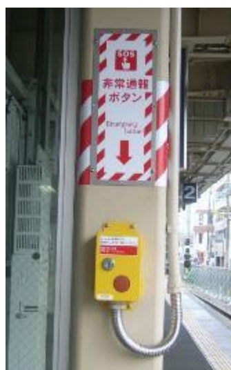
非常停止押しボタン
