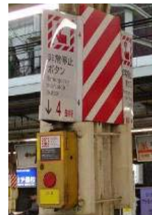
非常停止押しボタン
