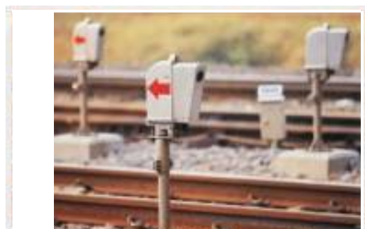
踏切障害物検知装置
