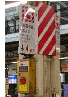
図3: 非常停止押しボタン
