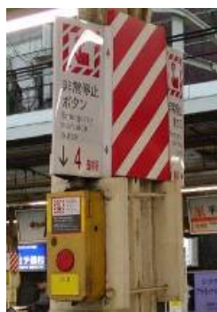
非常停止押しボタン
