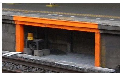
ホーム下の待避スペース
