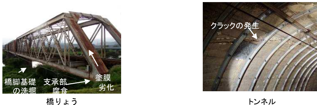
図4：老朽化が進んでいる施設の例
