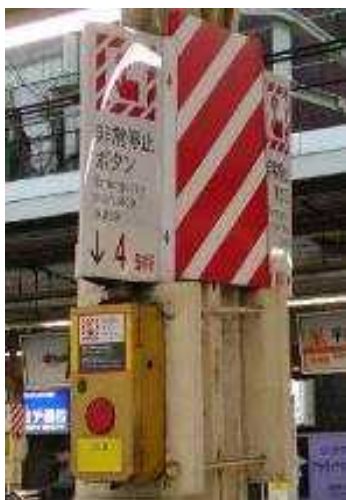
非常停止押しボタン
