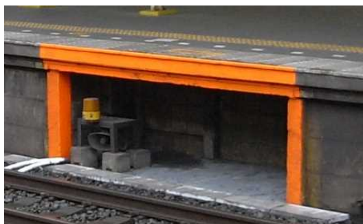
ホーム下の待避スペース
