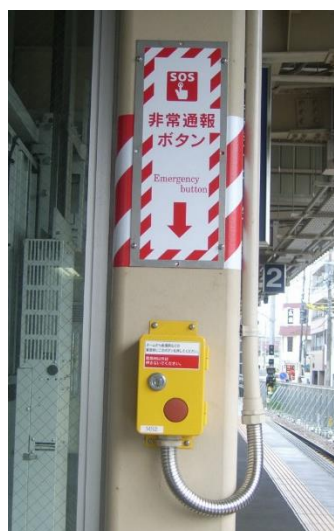
非常停止押しボタン
