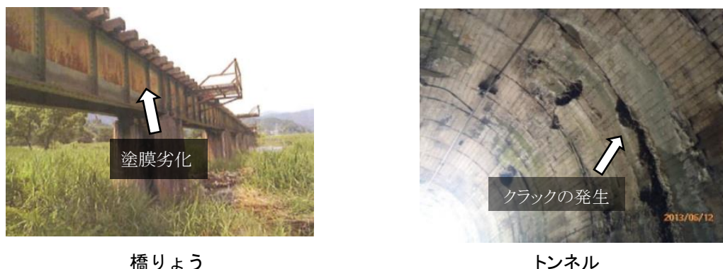
図4：老朽化が進んでいる施設の例
