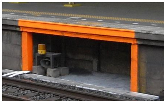
ホーム下の待避スペース
