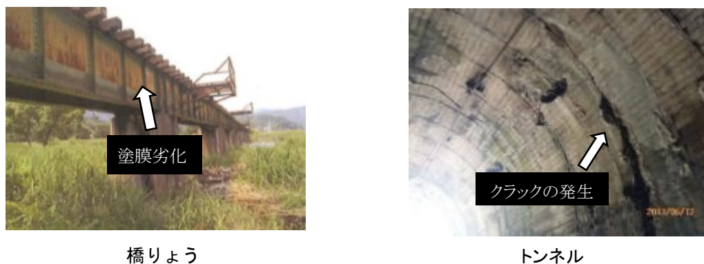
図4：老朽化が進んでいる施設の例
