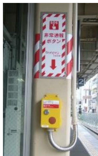
非常停止押しボタン
