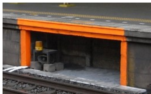
ホーム下の待避スペース
