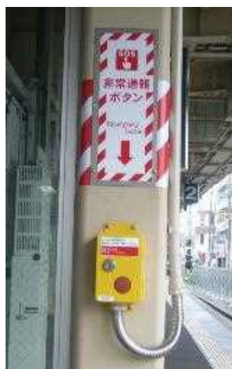
非常停止押しボタン
