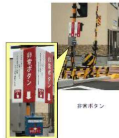
踏切非常通報装置(非常ボタン)
