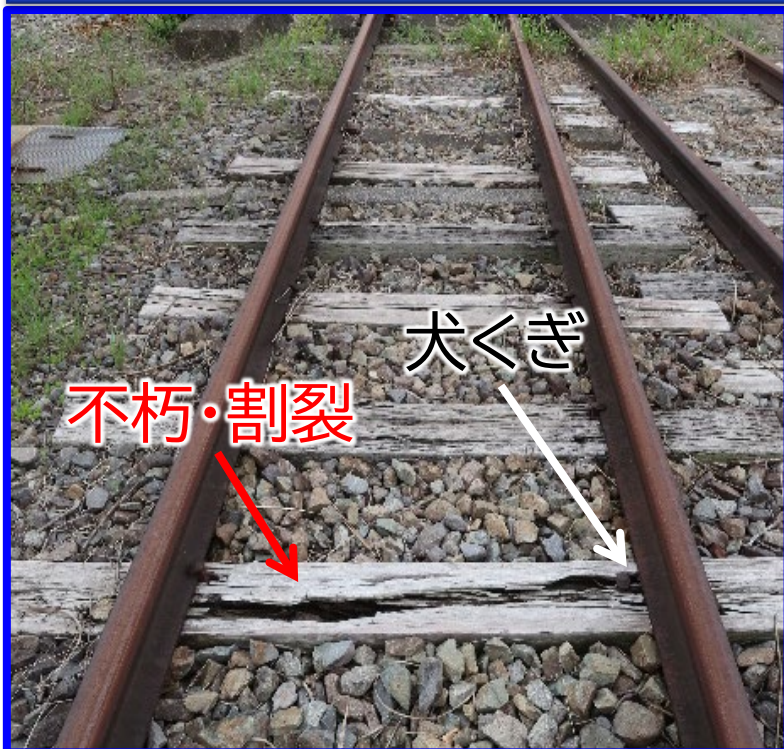
経年劣化した木まくららぎ
