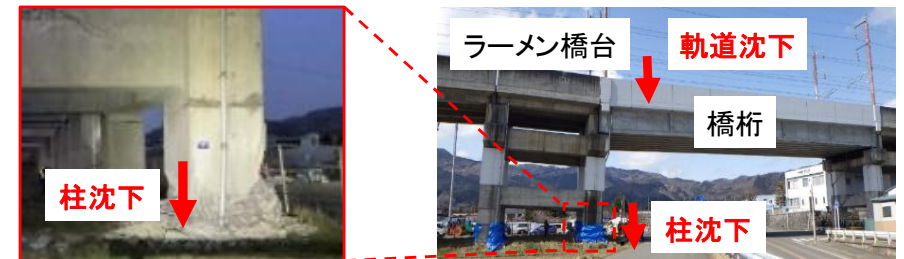
令和4年3月の地震による被害
