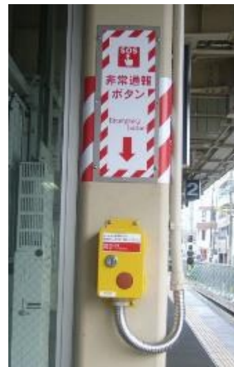
非常停止押しボタン
