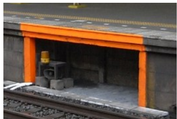
ホーム下の待避スペース
