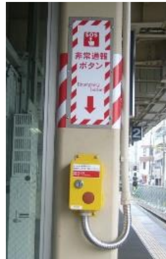
非常停止押しボタン
