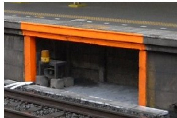
ホーム下の待避スペース
