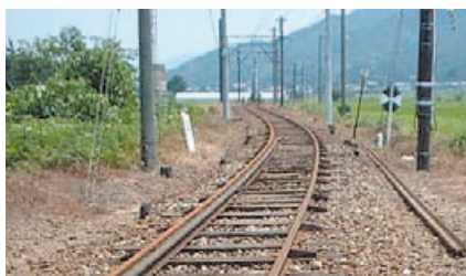
線路の変状、レール損傷、道床不良等
