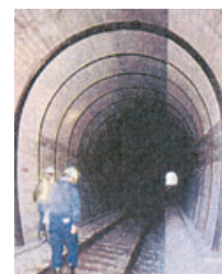
トンネルの変状、クラック、漏水等
