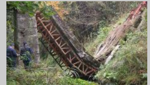
香川・徳島県境無名橋の落橋 (2007年)
