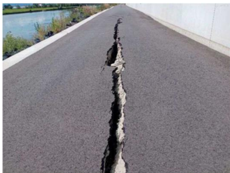
道路陥没ひびわれ (郡築ポンプ場付近)
