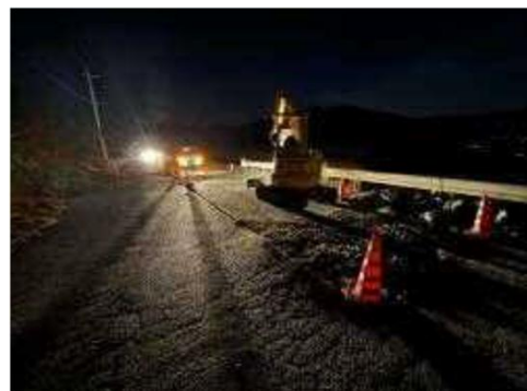
道路隆起 (県道32号線)
