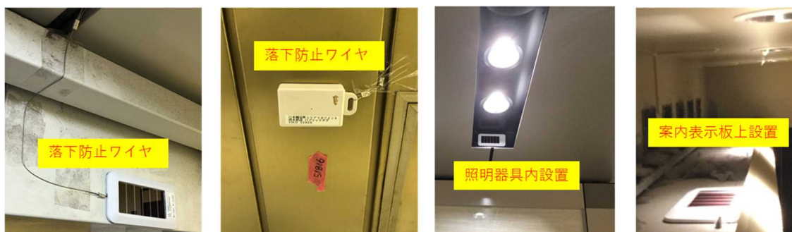
図 14. ビーコン設置状況
