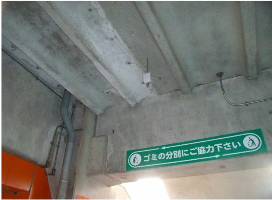
図 4.2-4 BLE ビーコン設置例(日産スタジアム ワイヤーでの設置)
