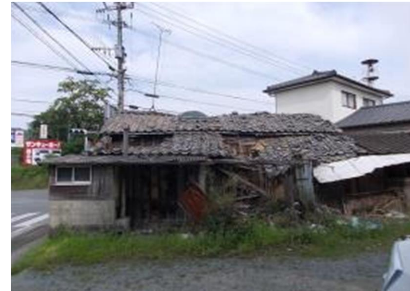
老朽危険家屋の空き家の現状
