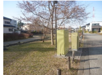
公園用地内に設置した 地上機器
