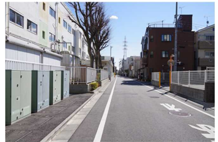
区画道路における無電柱化 学校敷地への地上機器の集約配置
