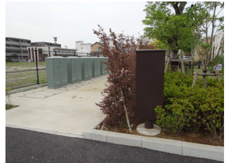
公園への地上機器の集約配置 利用者に影響がないよう設置を工夫
