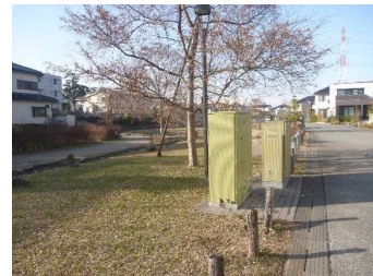
公園用地内に設置した 地上機器
