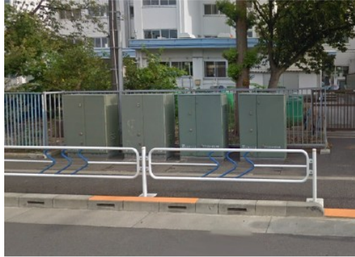
学校内に地上機器を集中配置した例 (東京都江戸川区)
