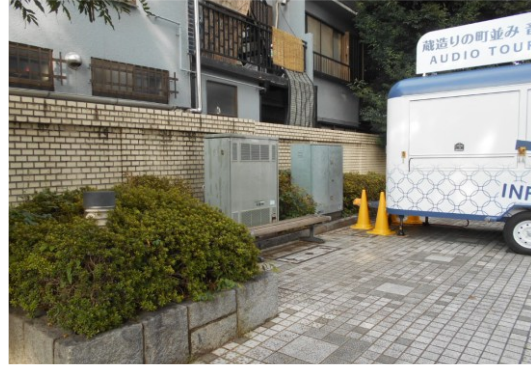
公園内に地上機器を設置した例 (埼玉県川越市)
