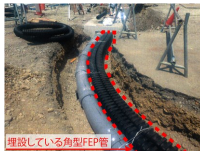
【写真】 多治見駅南地区の様子 (交通広場歩道部に曲げ半径約 5m で埋設)
