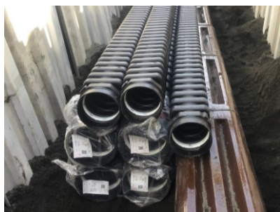
【写真】 港区泰明町地区の施工の様子 (骨格道路歩道部に角型 FEP 管を埋設)
