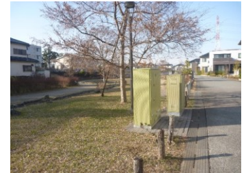
公園用地内に設置した地上機器
