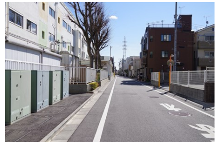
区画道路における無電柱化 学校敷地への地上機器の集約配置
