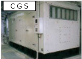
非常用発電機
