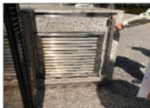
地下街の換気設備口
