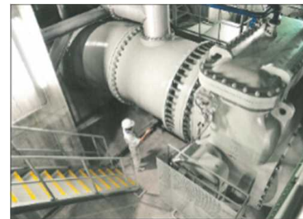
雨水ポンプの整備
