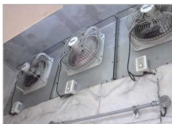
大規模換気設備
