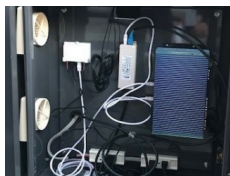
カメラの付帯設備
