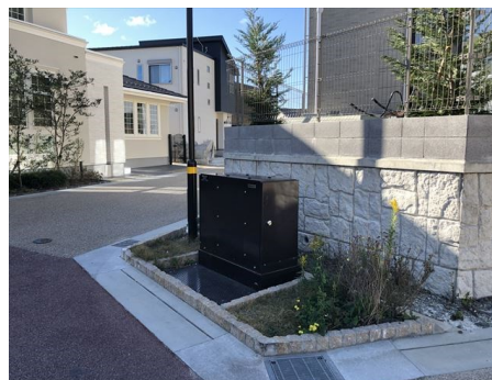
植栽帯の一部に地上機器を配置 （大阪府箕面市事例）
