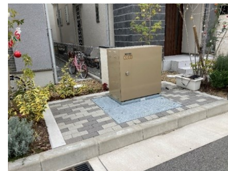
宅地間境界部に地上機器を配置 （兵庫県西宮市事例）
