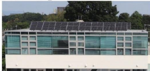
再生可能エネルギー(太陽光)設備
