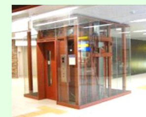
エレベーター
