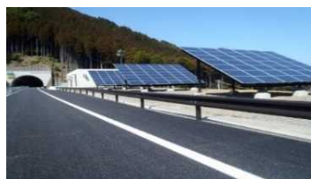
道路における太陽光発電施設活用
