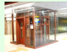
エレベーター
