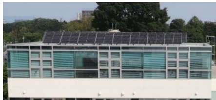
再生可能エネルギー(太陽光)設備
