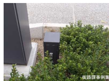
イベント用の電源設備
