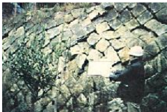
図-1 石積擁壁の崩壊
