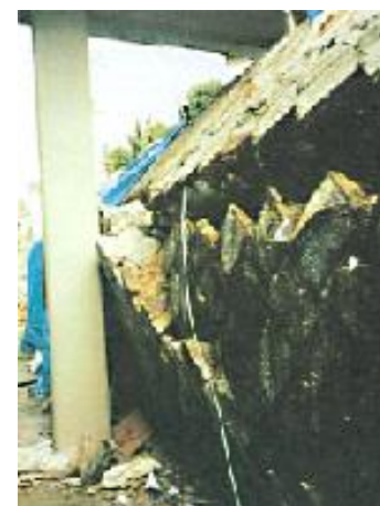
図-2 擁壁基礎部の機能消失
