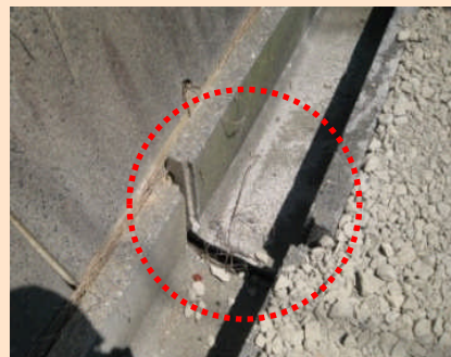
側溝の継目のずれ
