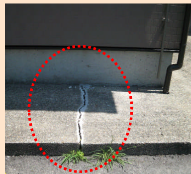
犬走りのひび割れ
