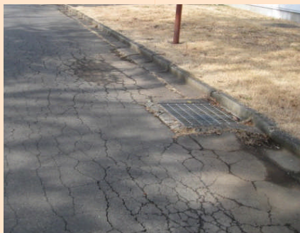
道路の沈下によるひび割れ
