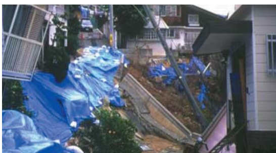
滑動崩落(兵庫県南部地震 最大震度：7)
