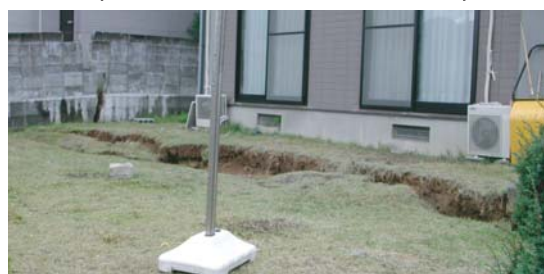
亀裂(新潟県中越地震 最大震度：7)
