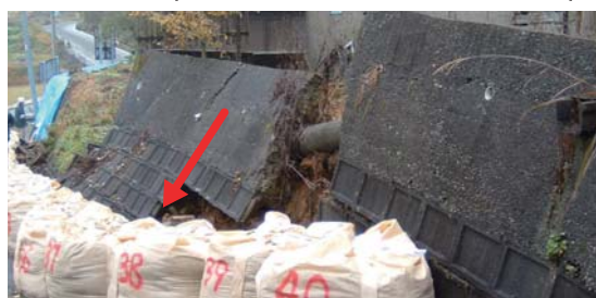
擁壁の倒壊(新潟県中越地震 最大震度：7)
