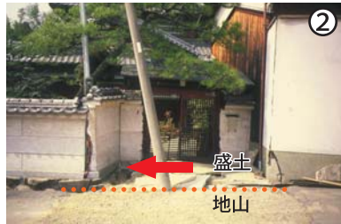
② 盛土中部では、手前の電柱がある地盤(地山)に対し、奥の家屋のある盛土部分が矢印の方向に滑っています。電柱はもともと門の左側にありましたが、住宅が右から左へ移動したため、門の前にきてしまいました。 (提供:釜井俊孝、守随治雄)
