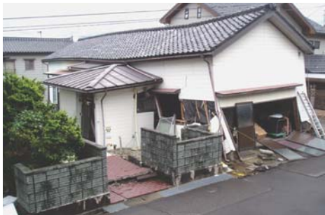
盛土内の被災状況（提供 柏崎市） 滑動崩落により宅地が変動し建物が破損
