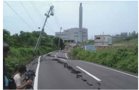
団地周辺部の被災状況（提供 柏崎市）
