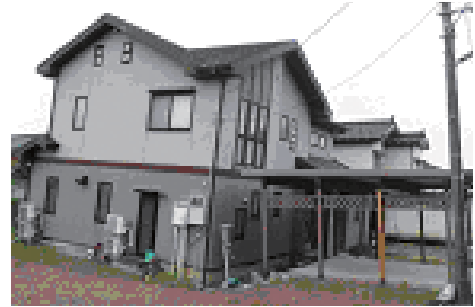
盛土内の被災状況 滑動崩落により宅地が傾き居住不能に
